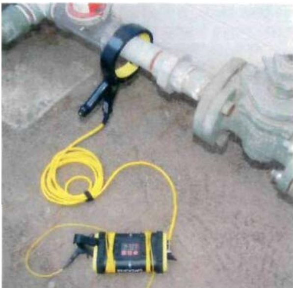
Рисунок 10: Индукционные клещи, подсоединенные к проводнику.
